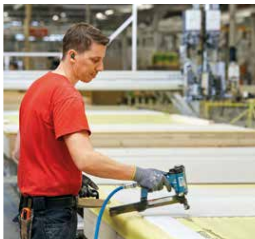
Rohstoff Holz: Das natürliche Baumaterial wächst nach und ist in der Ökobilanz CO 2 – neutral.
